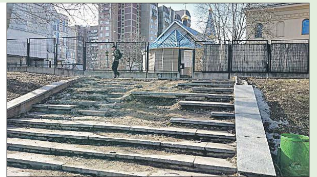
Провал на лестнице между храмом и прудом на Марьинском бульваре
